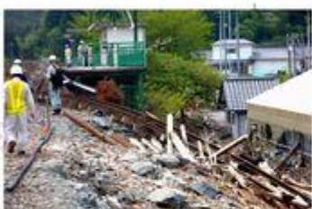
三陸鉄道 被災状況調査/復旧検討
